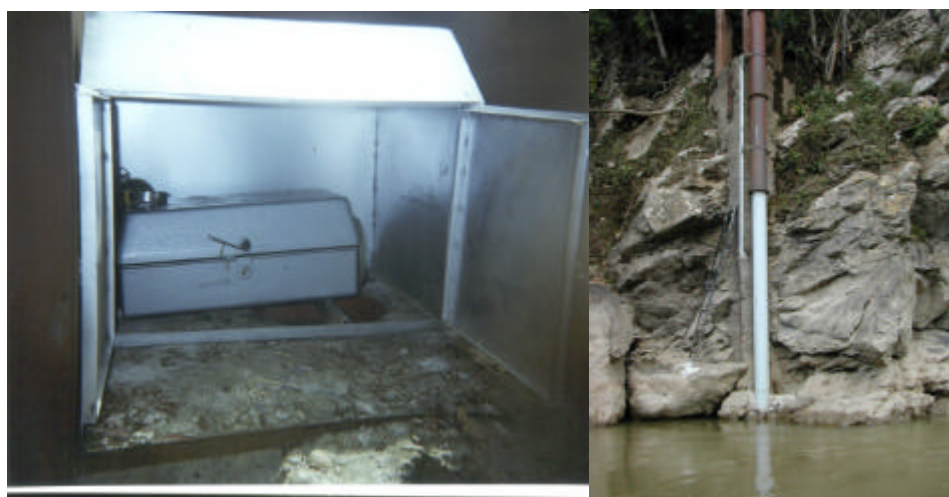
Figura 3 : Instalaciones realizadas : tubo PVC, escala de 500 a 900 cm, limnógrafo
