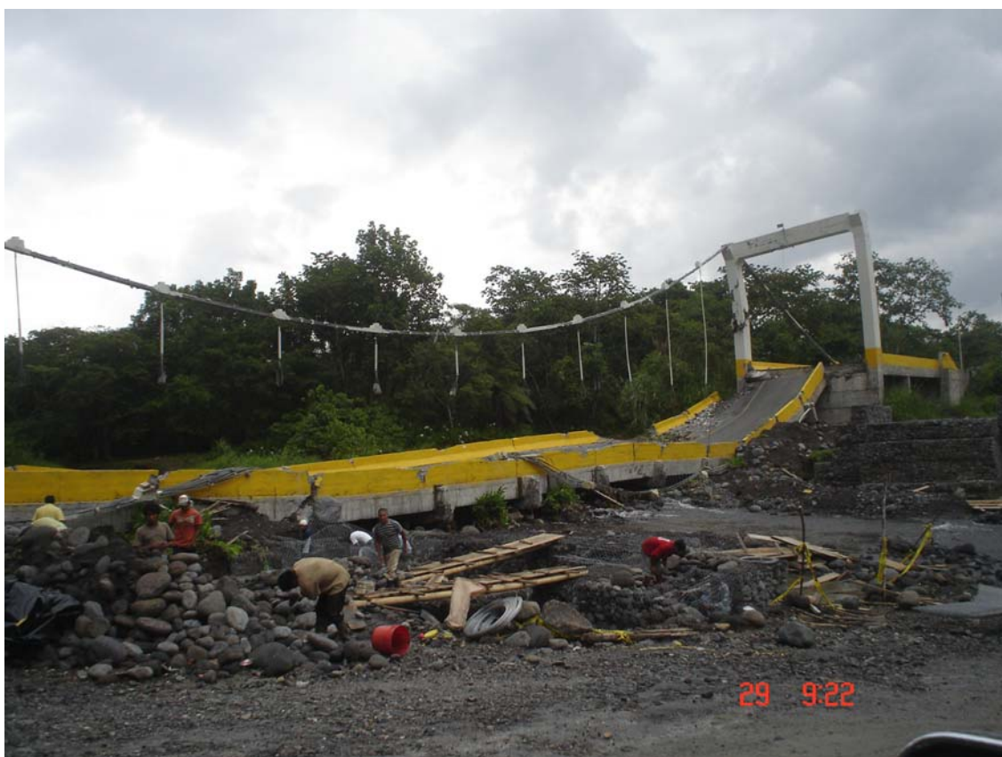
Foto 1: Puente caído sobre un ramal del Río Upano (localizado en Macas )
