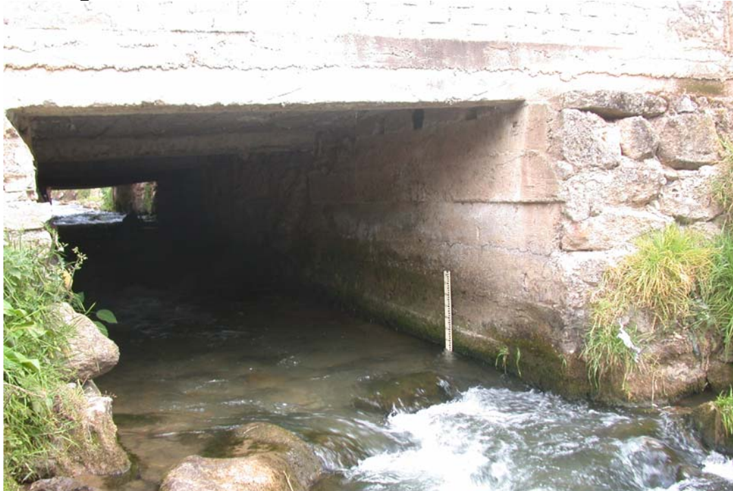
Foto 2: Regla instalada en Solocco
