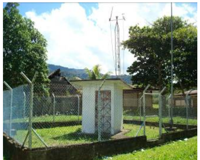
Foto N° 6: Estación Meteorológica Borja
